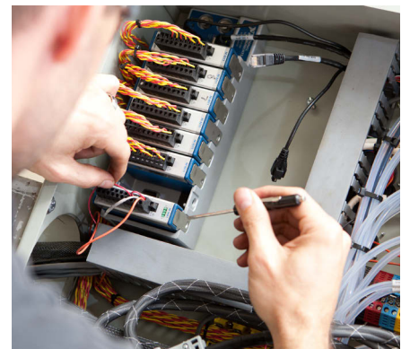
エンジンテストセルの一部となっている産業用エンクロージャ内のCompactDAQ
