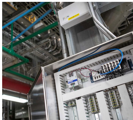
発電所に設置された産業用エンクロージャ内のCompactRIO
