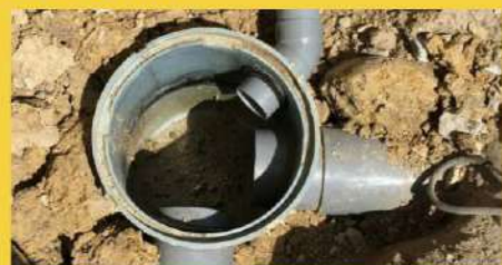
水道：配水管の錆、腐食、詰まりの診断
