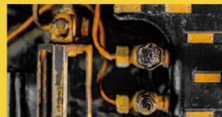
工場：大型機械、設備の保守点検
