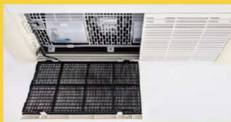
空調：エアコンの内部確認、ダクト内の保守点検
