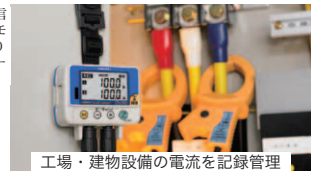
工場・建物設備の電流を記録管理
