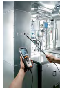
プラントのダクト内風速・風量
