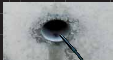
水道: 配水管の錆、腐食、詰まりの診断
